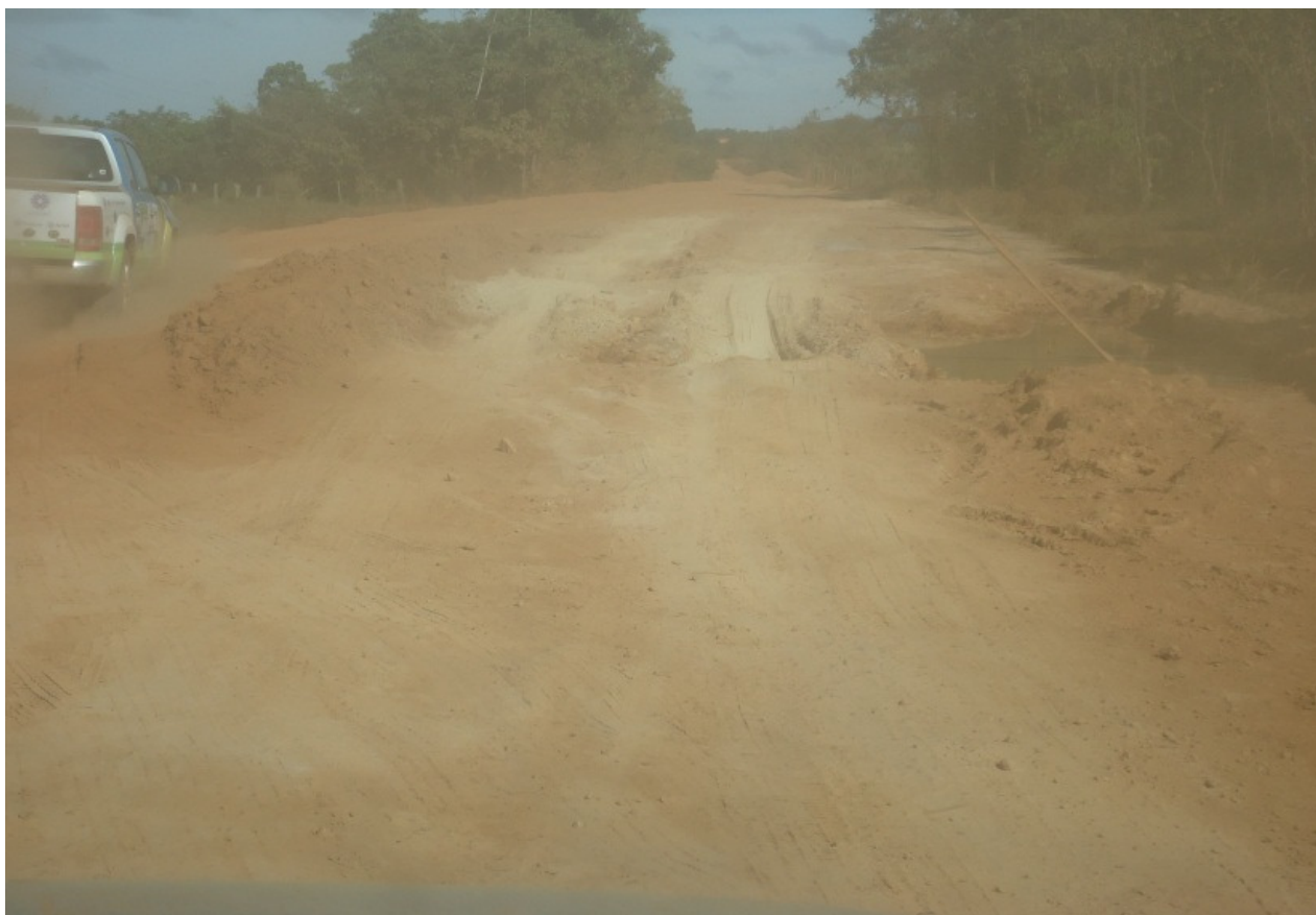
Foto 9 – Trecho implantado em péssimas condições de tráfego
