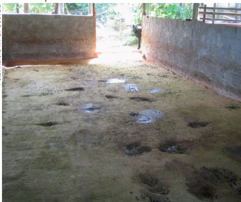
Piso de terra ("chão batido") com drenagem ruim
