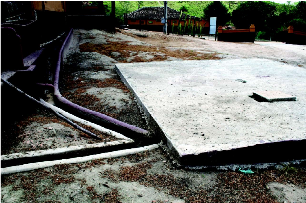
Piso de cimento inclinado sob o ripado, com canaleta de escoamento conduzindo ao tanque (chorumeira).
