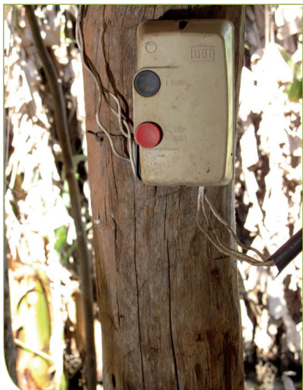
Instalação elétrica mal feita
