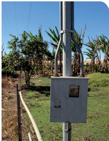
Instalação elétrica bem feita
