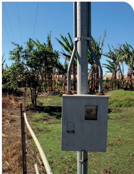
Instalação elétrica bem feita
