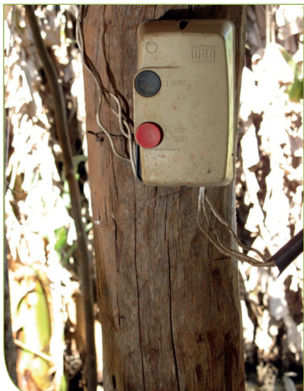
Instalação elétrica mal feita
