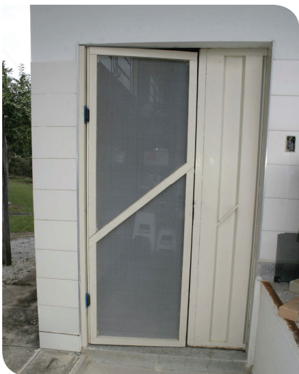
Portas com telas para impedir a entrada de insetos
