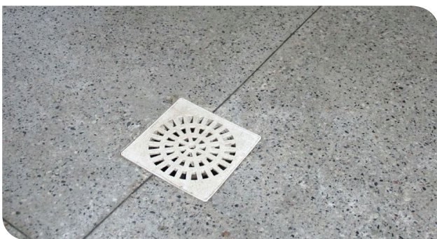
Piso com ralos para drenagem
