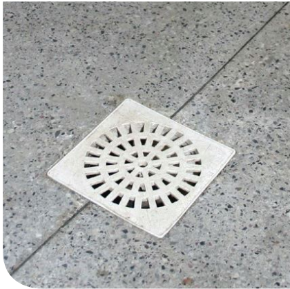
Piso com ralos para drenagem
