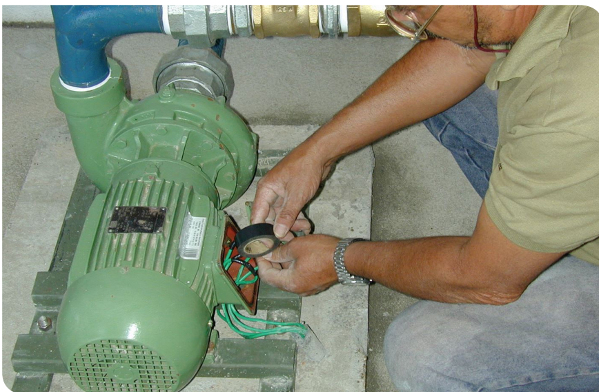
Ligação do motor à rede elétrica
