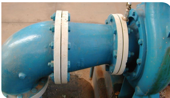
Redução excêntrica com conexão flangeada, adequadamente instalada
