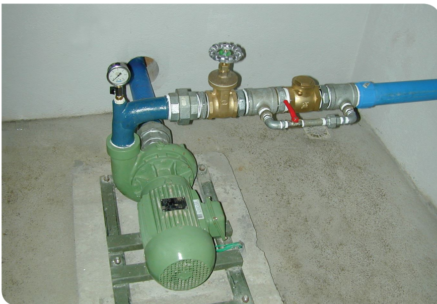
Vista geral da motobomba instalada no interior da casa de proteção
