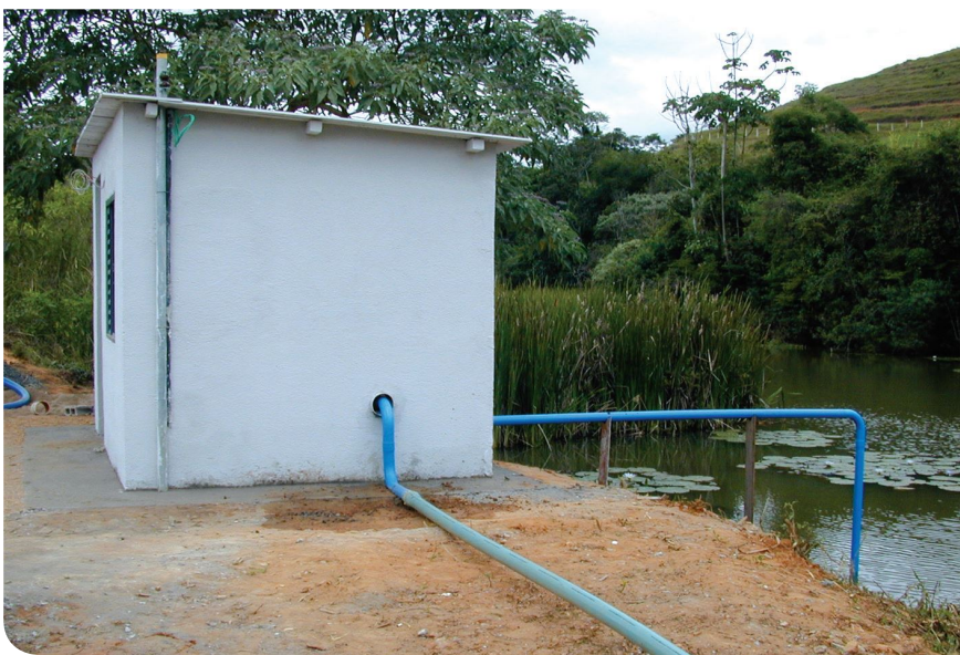
Vista geral da casa de proteção da motobomba, mostrando as tubulações de sucção e recalque
