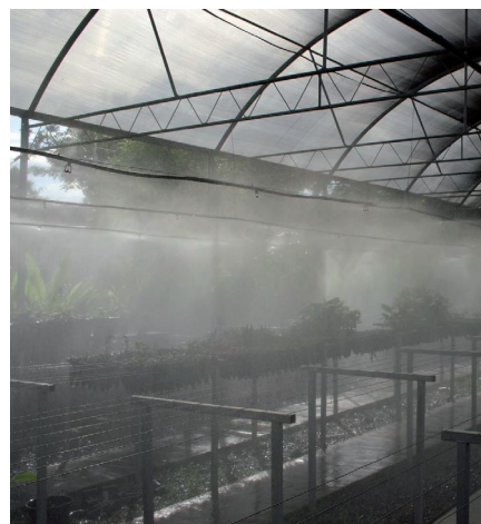
Irrigação em viveiros com sistema de irrigação por microaspersão
